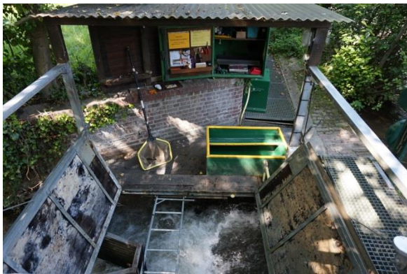
Figure 18: Vue du piège de montée en fonctionnement
