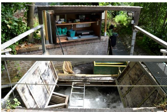
Figure 10: Vue du piège de montée en fonctionnement
