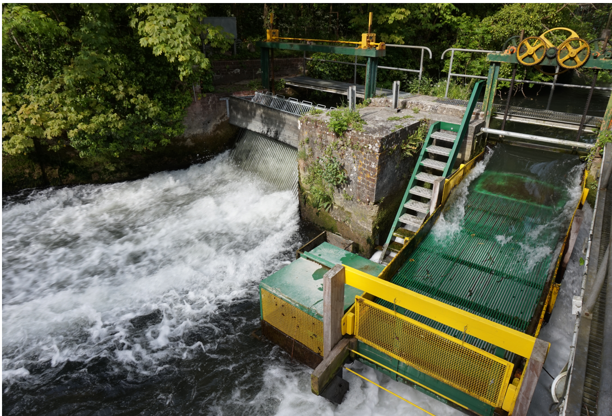
Figure V.4. Vue du dispositif de piégeage de dévalaison d'Eu en fonctionnement.
